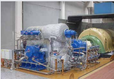
Neue Entnahme-Gegendruckturbine mit altem Generator New Extraction-Backpressure-turbine with old generator
